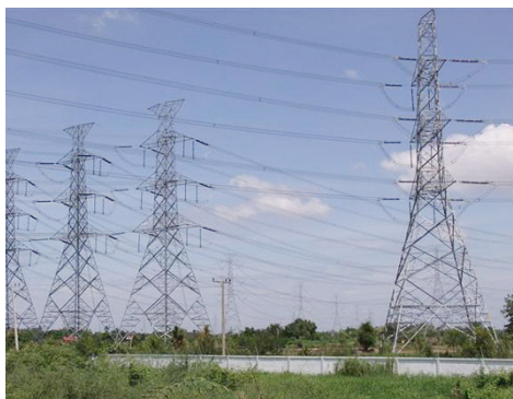
เสาไฟฟ้า
